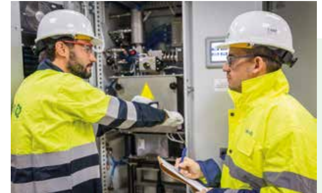
Instalación y puesta en marcha de sistema ABACO-LOI en Filipinas. Installation and commissioning of ABACO-LOI system in Philippines.
