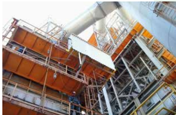
Instalación del sistema ABACO en la refinería Landulpho Alves, en Brasil.
