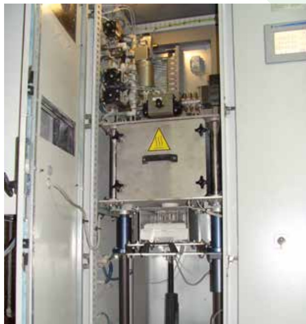
Instalación de la tecnología ABACO en una central térmica de Japón. Installation of ABACO system in a thermal power plant, in Japan.
