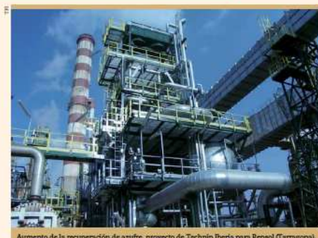
Aumento de la recuperación de azufre, proyecto de Technip Iberia para Repsol (Tarragona).
