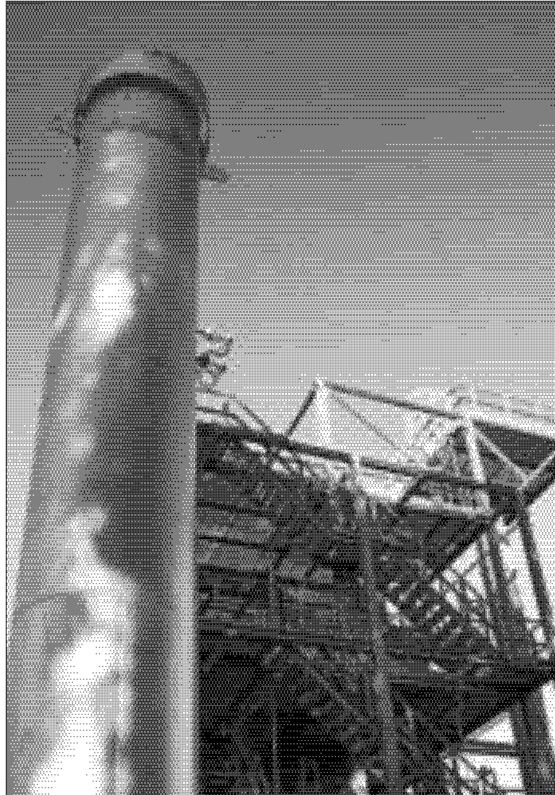
Planta de biomasa de Inerco en Sevilla.
