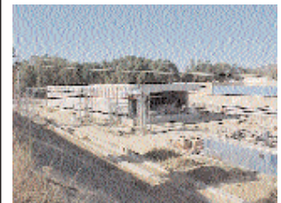
Nave del carrusel de llenado
