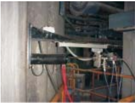
Sonda EMIR III instalada en central térmica
